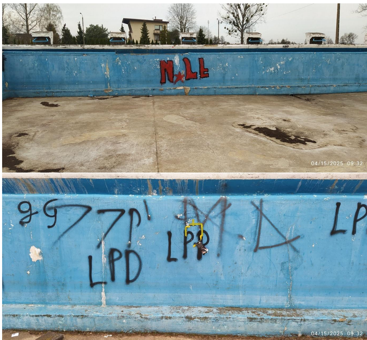
RYC. 15 PRZESTRZEŃ BASENU MIEJSKIEGO DOTKNIĘTA AKTAMI WANDALIZMU
